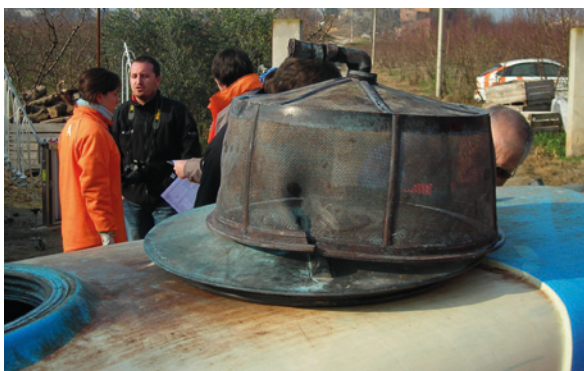
Filtro de llenado en condiciones no aceptables
